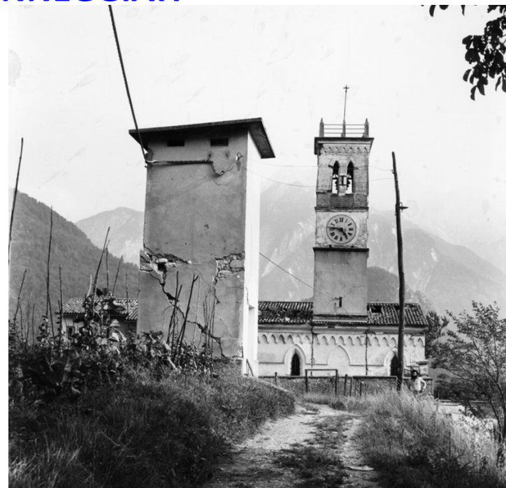
La cabina MT/BT di Ovedasso con la muratura fortemente lesionata verrà successivamente demolita
